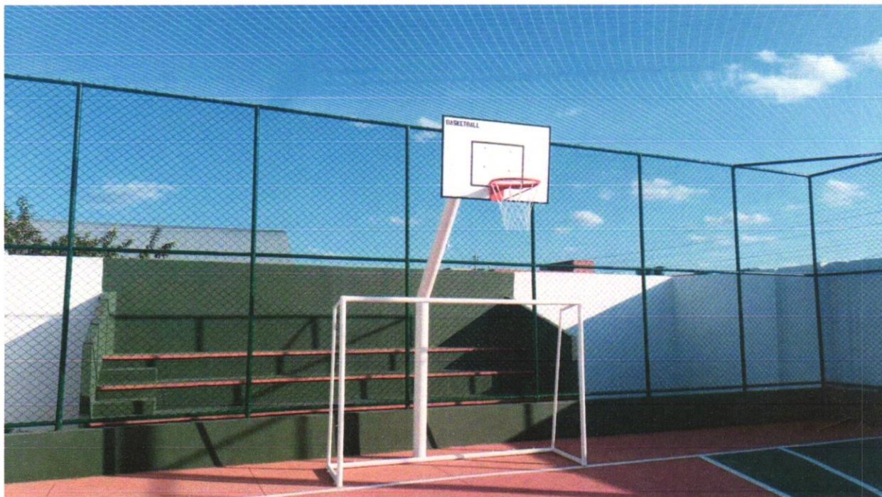
Foto 04 - Estrutura metálica fixa, p/ tabela em aço com aro e cesta p/ basquete, padrão oficial, em tubo galvanizado d=5" - instalada
